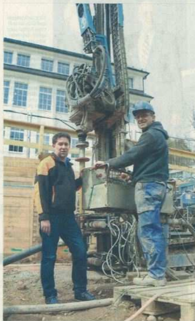
Unter ihnen geht es hundert Meter in die Tiefe. Geologe Rüdiger Grimm (l.) steht mit Maschinenführer Marko Goldbach am Bohrer für die Erdwärmennutzung beim Neubau der Uhrenmanufaktur von Lange in Glashütte.
